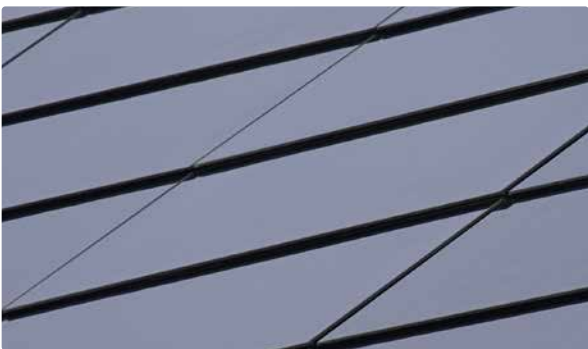
Aansluiting van de PV-panelen van Navitect II
